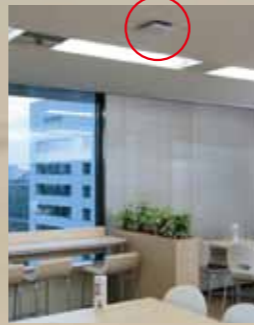
カフェテリアなども含め、オフィスのあらゆる場所の天井に、無線LANのアクセスポイントが設置。
